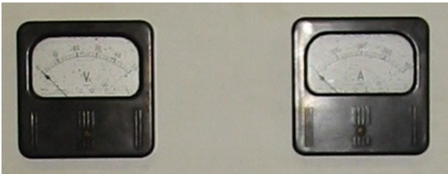
Figuur 42: Volt- en Ampèremeter (close-up)
