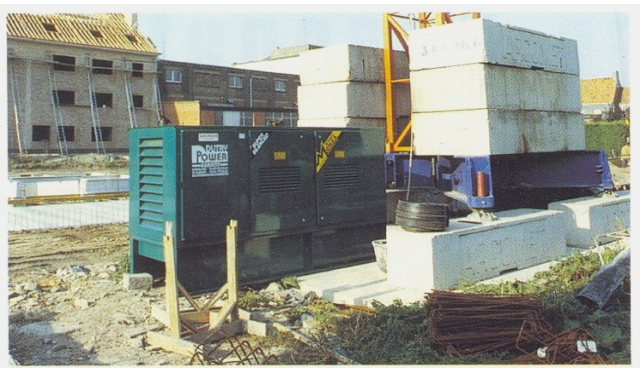
Figuur 2: stroomgroep op een bouwwerf
